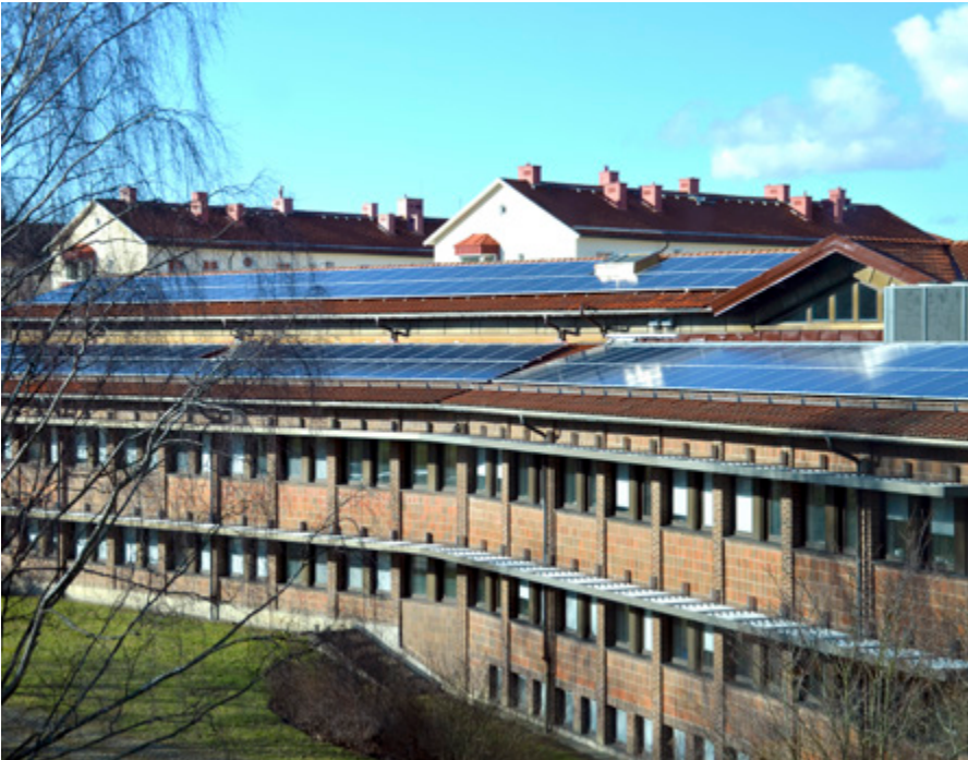
Stadens första solcellanläggningar för elproduktion. På stadshuset och gatukontorets lokaler på Skedebro har solcellanläggningar installerats. De förväntas producera ungefär 37 000 kWh respektive 30 000 kWh el årligen. Med detta uppfylls stadens miljömål samtidigt som behovet av köpt energi minskas. Foto: Sonja Skäär
