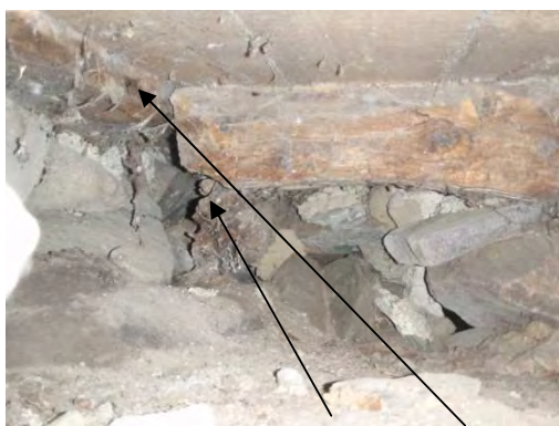
Bild 1. Rötskador i bärlina samt syll.
