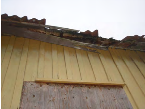
Bild 8 & 9. Rötskador i takkonstruktion.
