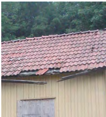
Bild 12. Kraftiga rötskador i takkonstruktion.
