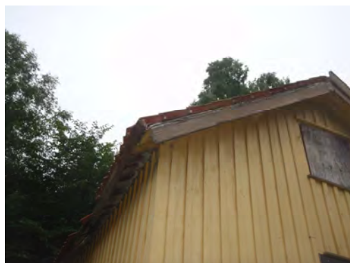
Bild 10. Rötskador i vindskiva.
