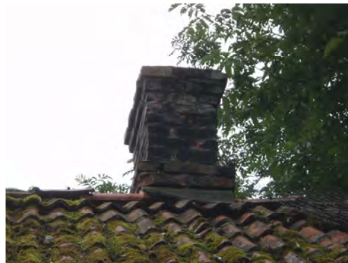
Bild 13. Skador i skorsten.
