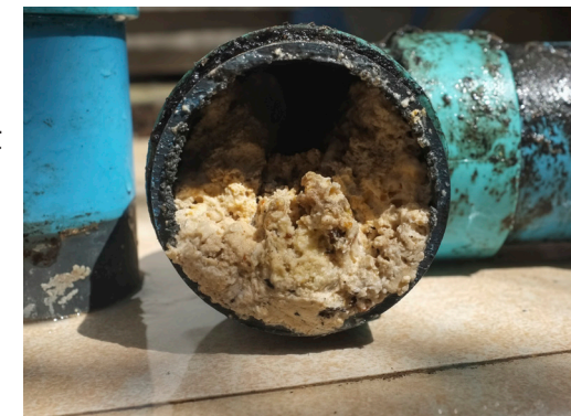
Stelnat fett i avloppsrör.
